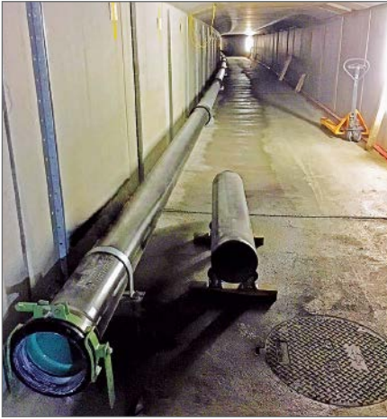
Löschwasserleitung entlang des Werkleitungskanals.
