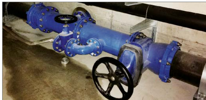
Streckenschieber, Entleerungs- und Reinigungsstutzen sowie Seitenabgang zu Stichleitungen für Hydranten.
