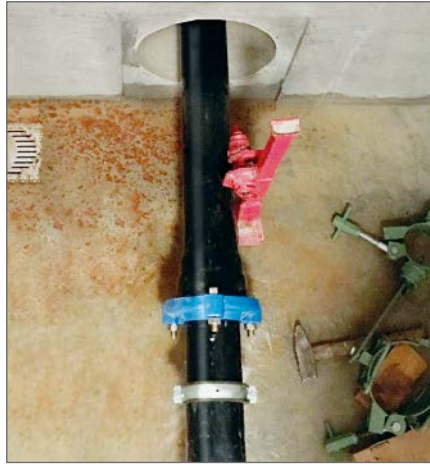
Stichleitungen vom Werkleitungskanal in die Hydrantenkammer.
